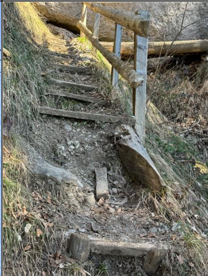
05.03.2025: Unterhaltsbedarf am Steiglenweg
